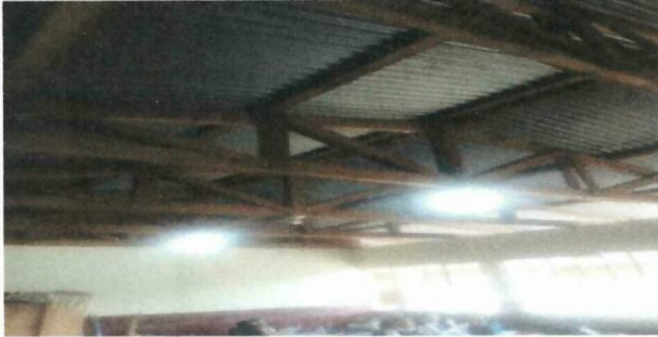
Foto1: El techo de estructura de madera y lamina acanalada provoca demasiado calor en aulas, se considera que un cambio por una losa es la solución para crear un ambiente más fresco.
