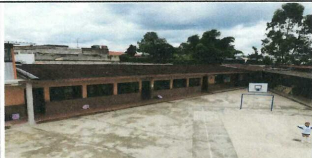
Foto 6: toda el área se hará sustitución de láminas.
