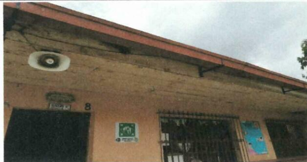
Foto 3: se colocará nueva cubierta con lámina troquelada.
