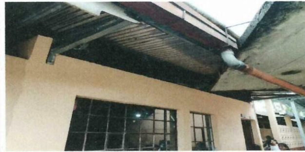
Foto 4: se colocará cielo falso y canales apropiados.
