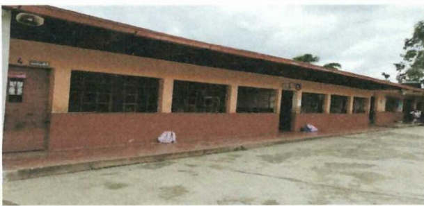
Foto 5: se realizará cambio general al entechado.
